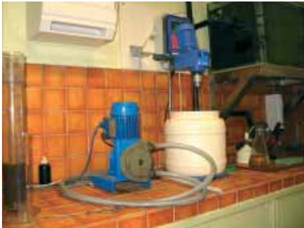
Série PMA utilisée en échantillonnage (auto surveillance) dans une station d'épuration.
