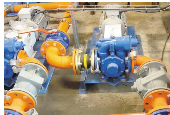
Transfert de fioul domestique
