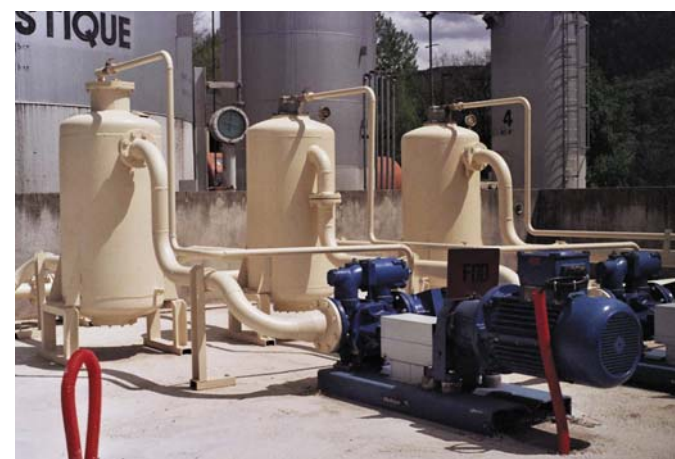
Transfert de soude caustique
