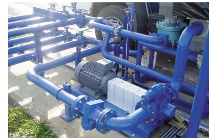
Dépotage camion (Gasoil)
