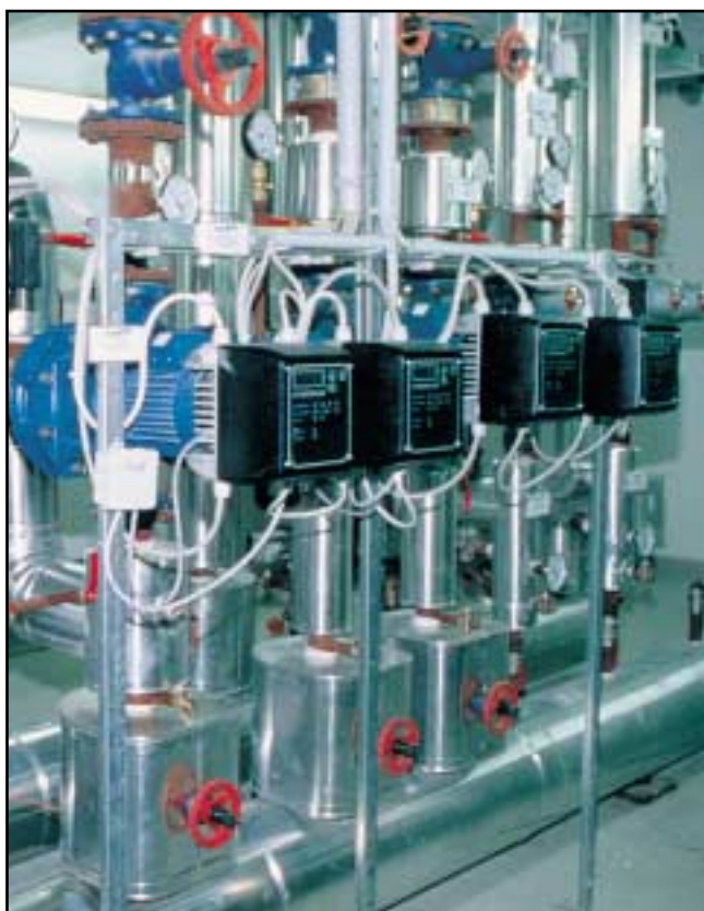
Pompes de circulation de chauffage
