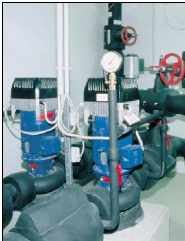
Pompes de circulation d'eau de refroidissement
