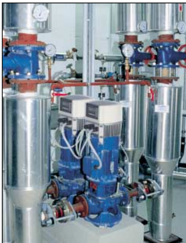
Pompes de circulation pour échangeur thermique
