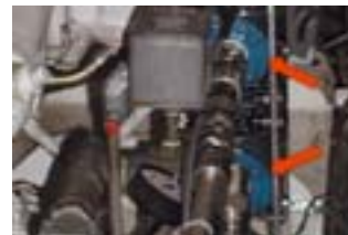
Le débitmètre KRAL installé dans le compartiment moteur du Lara
