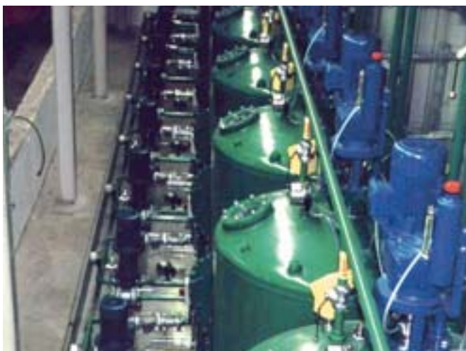
Vue d'un réservoir de polyol équipé de pompes KRAL
