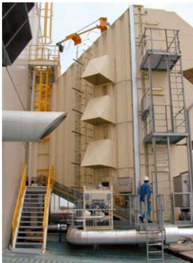
[Local de filtration avec conduite d'alimentation de baie à tuyères
