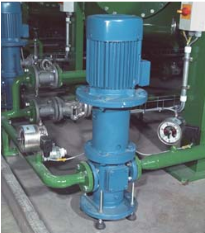
Pompe à vis KRAL à entraînement magnétique utilisée comme pompe de transfert
