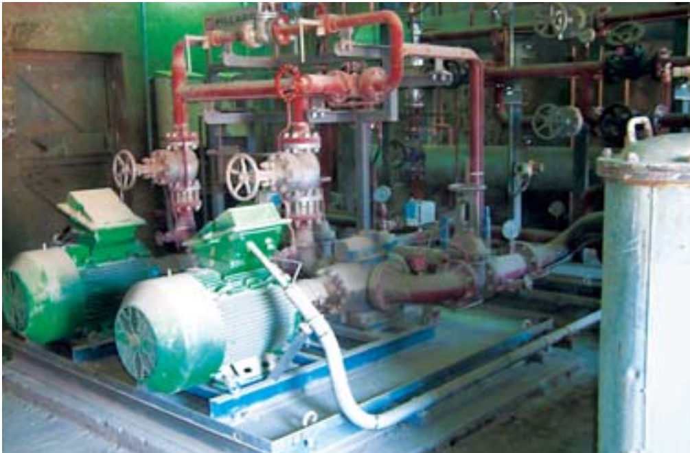
Installation de groupes moto-pompes KRAL dans une cimenterie
