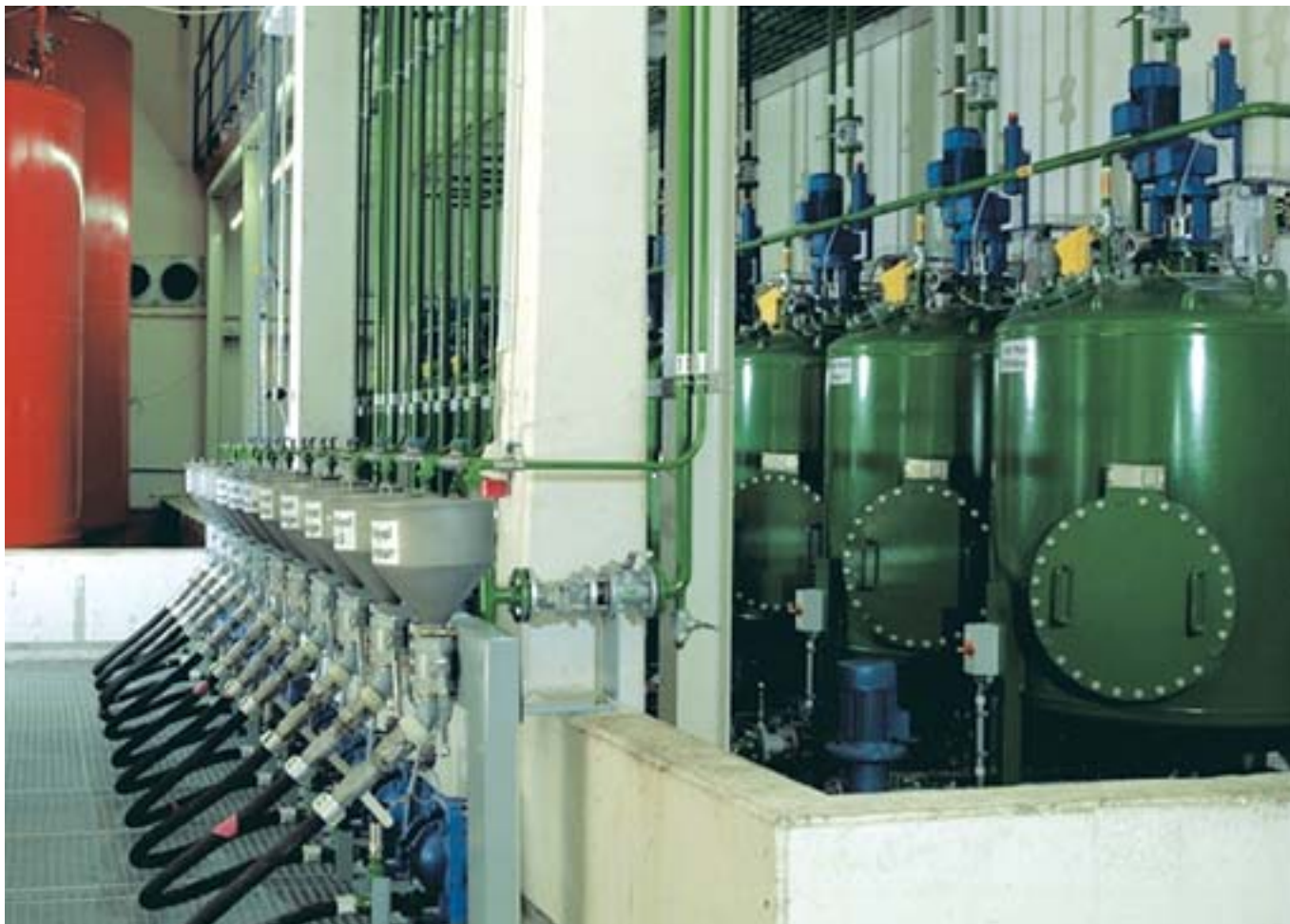
Site de stockage - à gauche, le réservoir d'isocyanate (orange) et à droite, les réservoirs de polyol (vert)
