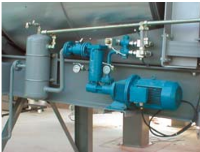
Installation de séchage Ammann avec pompe KRAL
