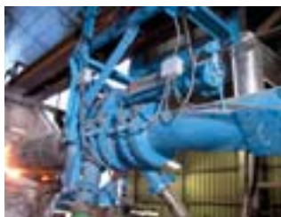
Tuyère 35 MW fuel/charbon spécialement équipée pour des tests
