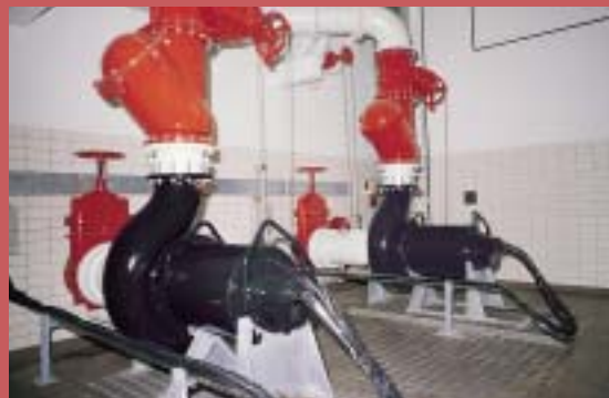
Pompes installées horizontalement avec chemise de refroidissement.
