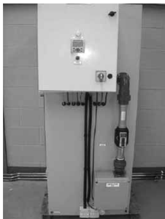
Electrolyseur 125-2000 g/h Cl 2
