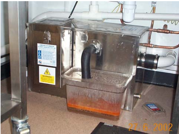
Installation sous plonge
