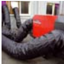
Gaine de recirculation.
