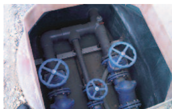
Regard avec robinetterie revêtue époxy et pré moule de dalle de propreté
