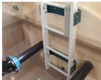
Echelle avec crose rétractable dans la chambre à vannes
