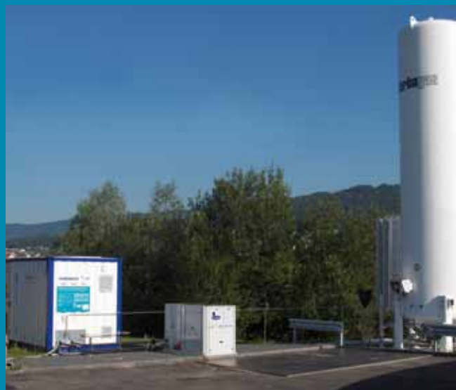
Station de traitement à l'ozone WEDECO de la station de traitement des eaux usées de Wueri à Regensdorf en Suisse.
