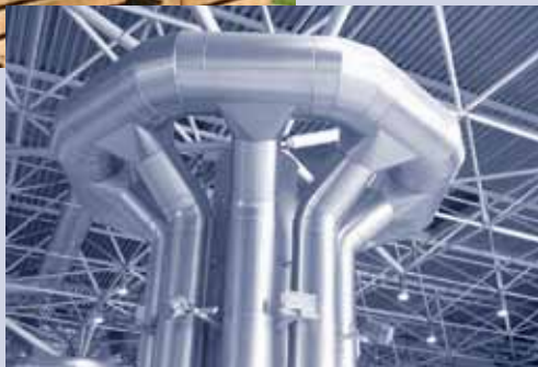
Be- und Entlüftung Ventilation
