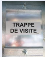
Trappe de visite + perçage d'évacuation sur le ventilateur
