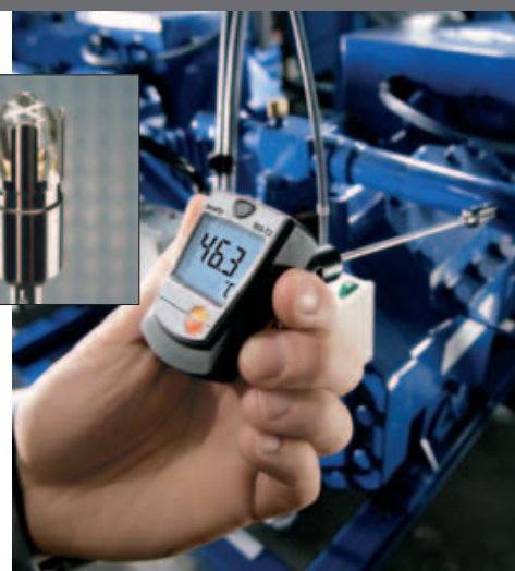
Contrôle de la température de surface pour installations frigorifiques
