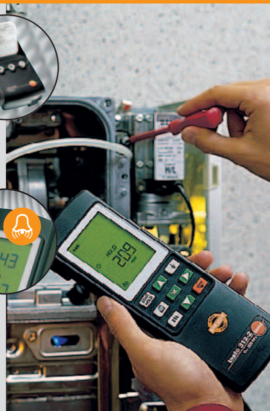
Mesure de la pression différentielle sur les installations de chauffage
