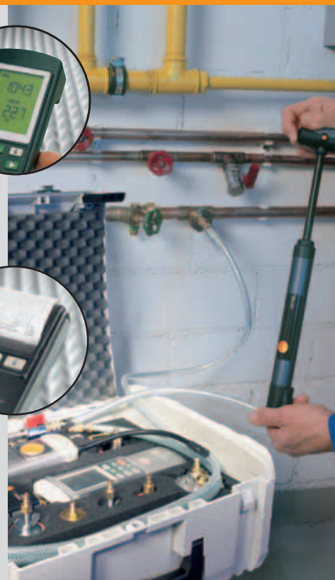
Contrôle de la pression sur des conduites d'eau (contrôle avec une pression d'air de 3-5 bar)
