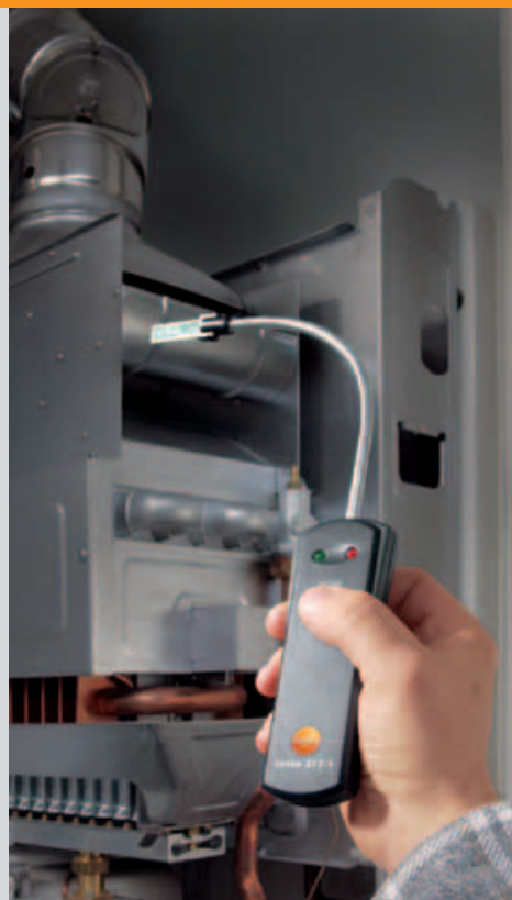
Confirmation de la bonne évacuation des gaz de combustion
