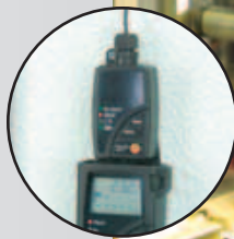
Recopie du signal d'alarme
