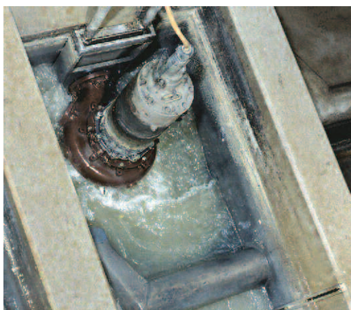
Pompe immergeable fonctionnant le moteur dénoyé.
