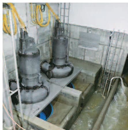
Pompes fonctionnant dénoyées pour eaux pluviales.
