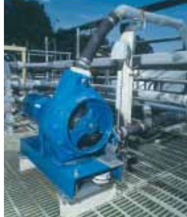
Pompe Z en neutralisation d'effluents
