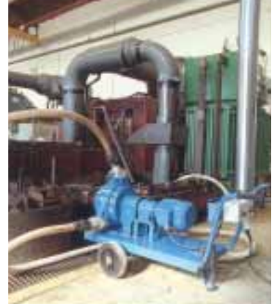
Pompe Z en vidange de puisards
