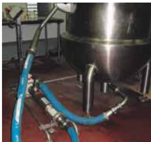
131A6 dans l'industrie des sauces pour transfert de ketchup ou mayonnaise depuis le cuiseur vers le stockage.
