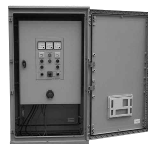
Armoire de trottoir
