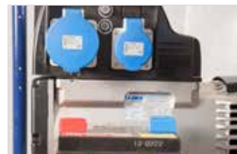
Quadro elettrico superiore monofase con una presa da 32A e una da 16A con termiche di protezione Upper single-phase electrical panel with one 32A and one 16A socket with thermal cut-out protection
