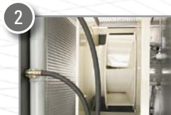
2 Turbine de ventilation
