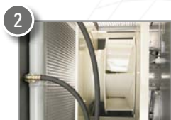
Turbine de ventilation
